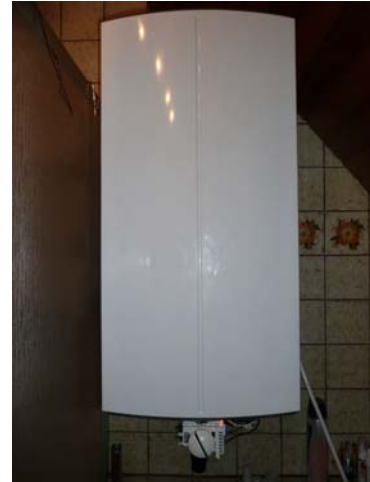
Am Boiler ist die Abdeckung unten bereits entfernt. Der Temperaturregler ist wieder aufgesteckt.
